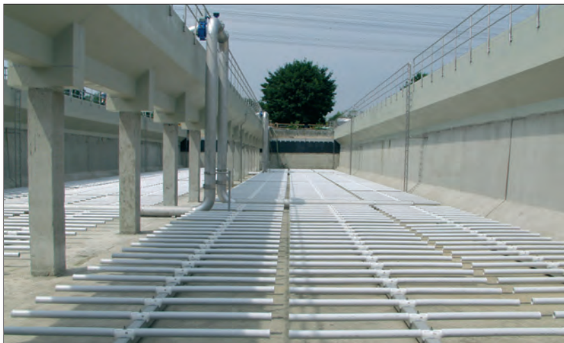
Station de traitement des eaux usées: aérée avec les diffuseurs à membrane MAGNUM®2000 FLEXSIL®.
